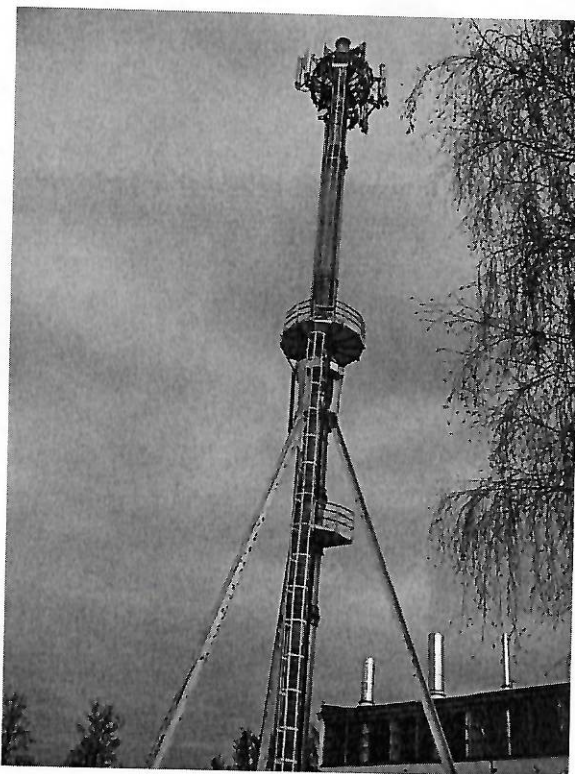
Zał. nr 1: Widok ogólny instalacji radiokomunikacyjnej.
